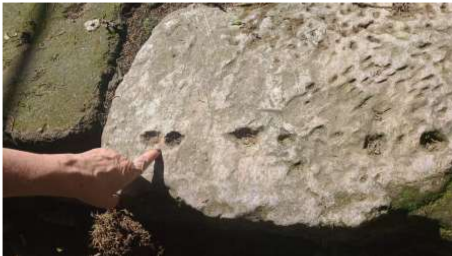
Imagem 22 - Detalhe de alicerce pétreo base de parede de Pau a Pique. Tripuí, Ouro Preto. Foto: M. Dionízio, dez. de 2024.
